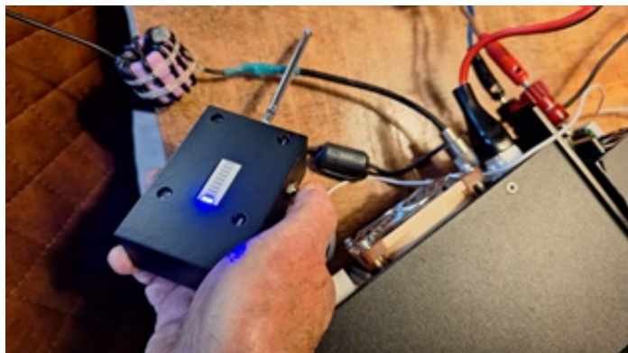
Mantelstroom filter, sniffer aan de uitgang van het filter.... Géén spanningsmaximum meer....
